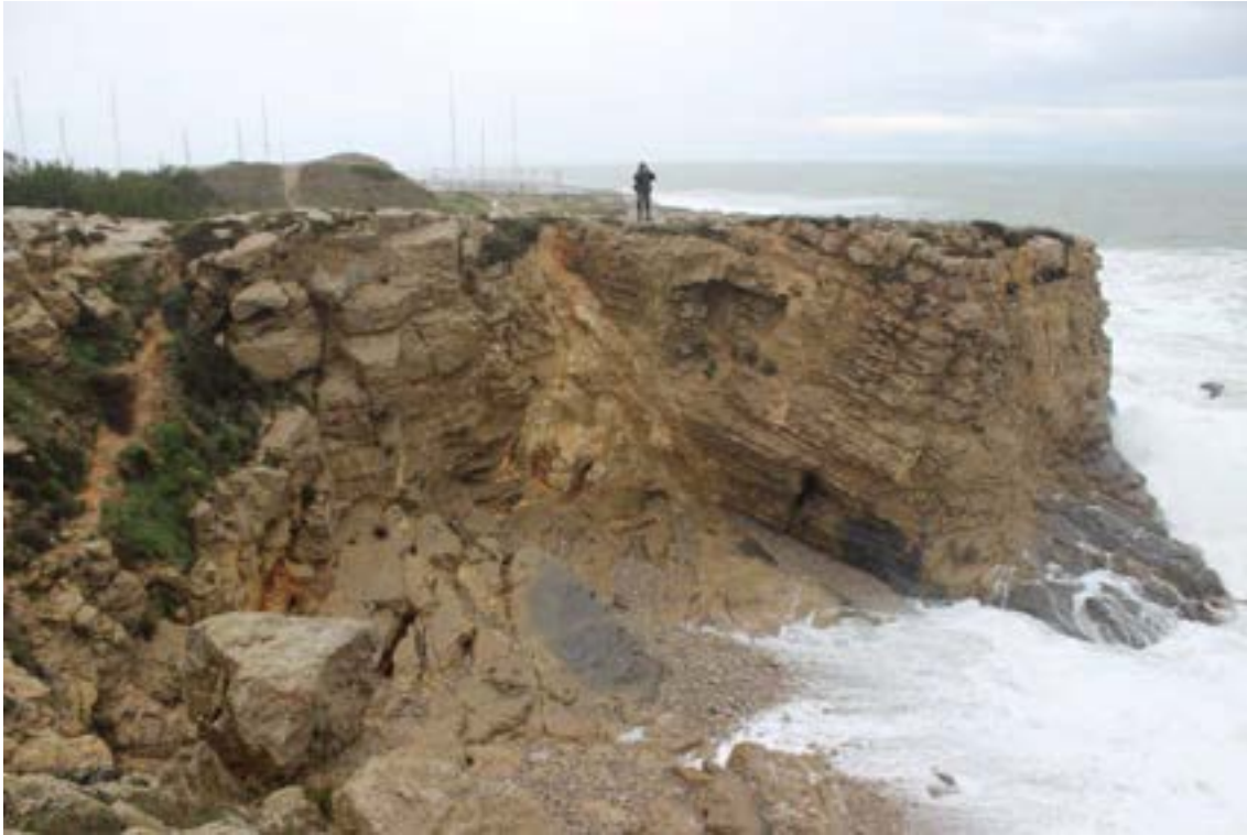
Fotografia 9. Detall del mateix escarpament on s'aprecien blocs de gran magnitud caiguts i punts on es presenta erosió per acció del mar de la base de l'escarpament.
