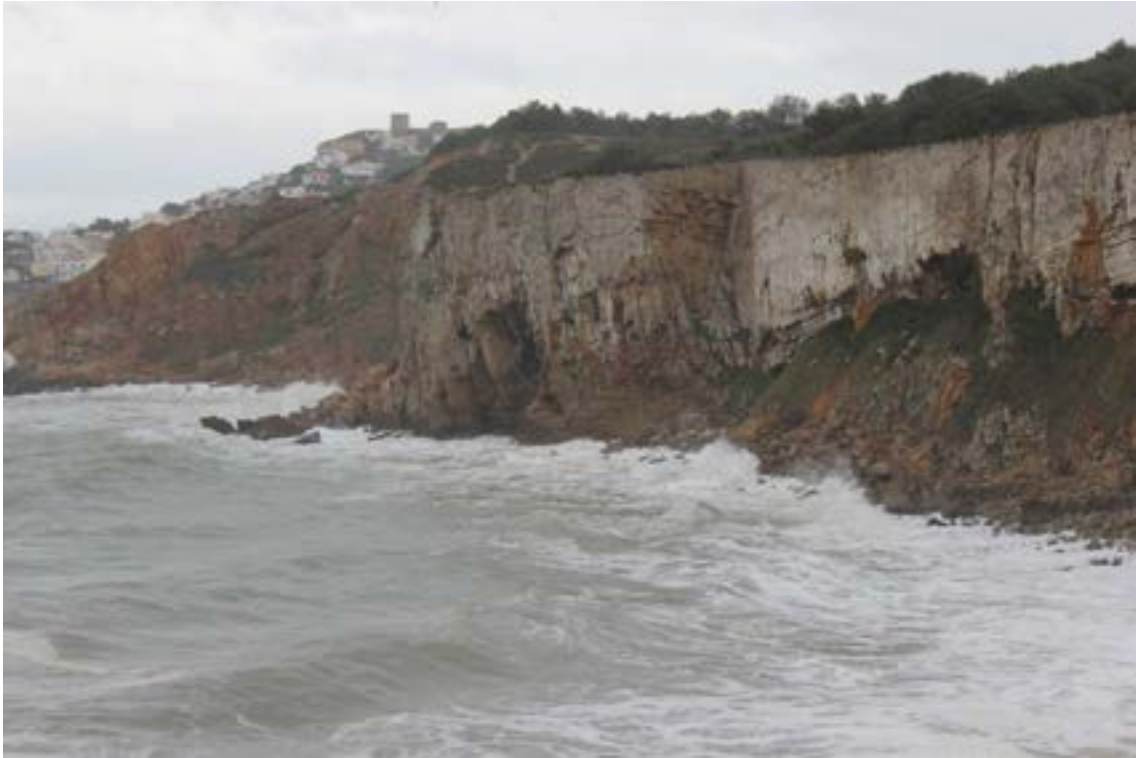
Fotografia 10. Detall de la Punta dels Cinc Sous on s'aprecia l'erosió basal de l'escarpament i l'acumulació de materials caiguts al seu peu.
