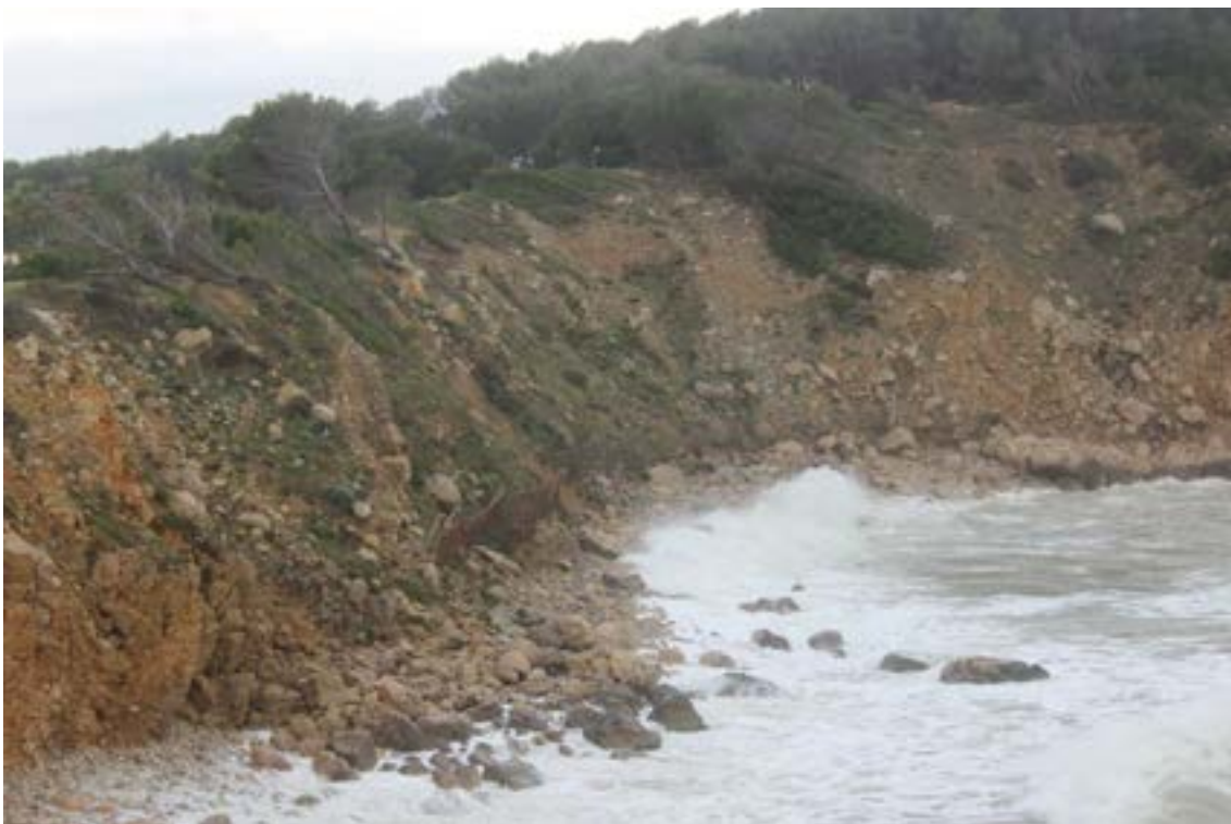
Fotografia 12. Dipòsits neògens on s'identifiquen blocs mètrics individualitzats, i on s'hi ha instal·lat una barrera dinàmica per a minimitzar els efectes de les caigudes de blocs
